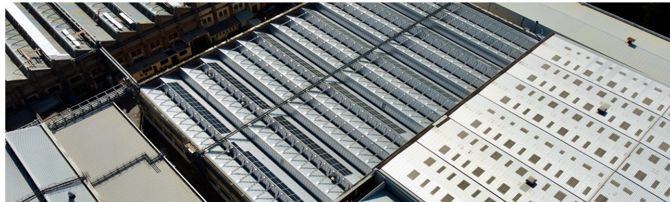
Impianto fotovoltaico OMCL Foligno
